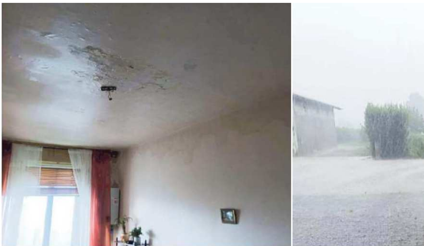
Infiltrazioni in una delle case in Riviera a rischio evacuazione, a destra la pioggia mista a grandine che ha colpito anche ieri il Portogruarese
